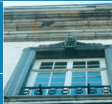
Les pierres et châssis ont longuement souffert.
